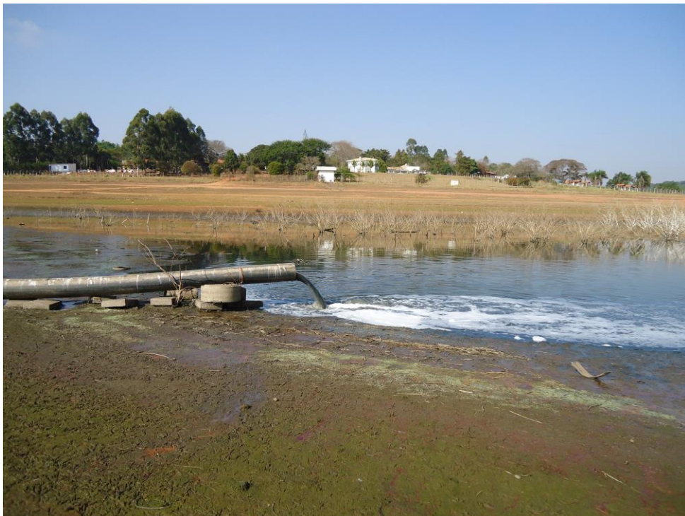
Figura 34 – Despejo de efluente no leito quase seco da represa, próximo à Rampa Náutica. Fonte: Evânio S. Branquinho, ago. 2017.
