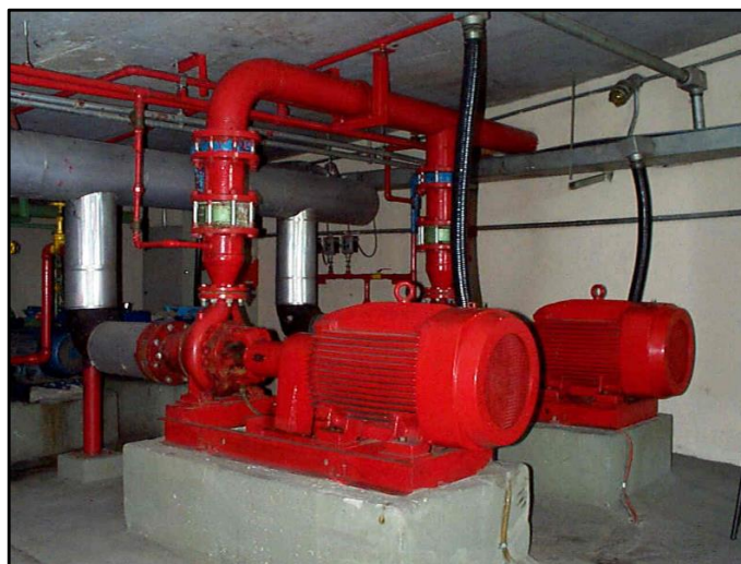
Figura 32 – Bombas de suprimento de água
