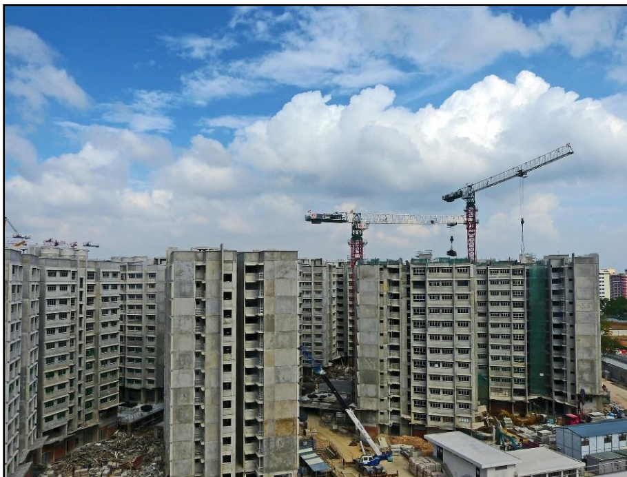
Figura 24 – Meios de acesso indeterminados em edifícios em construção
