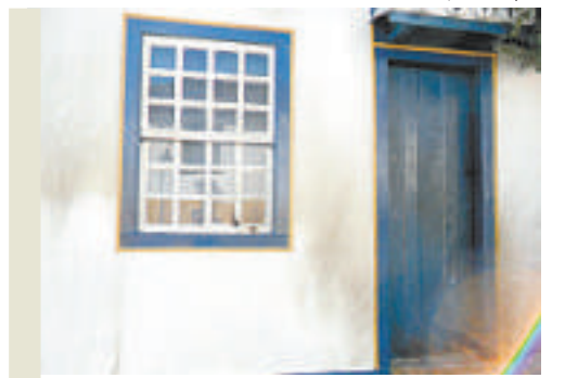
Chamas danificaram a porta do imóvel
