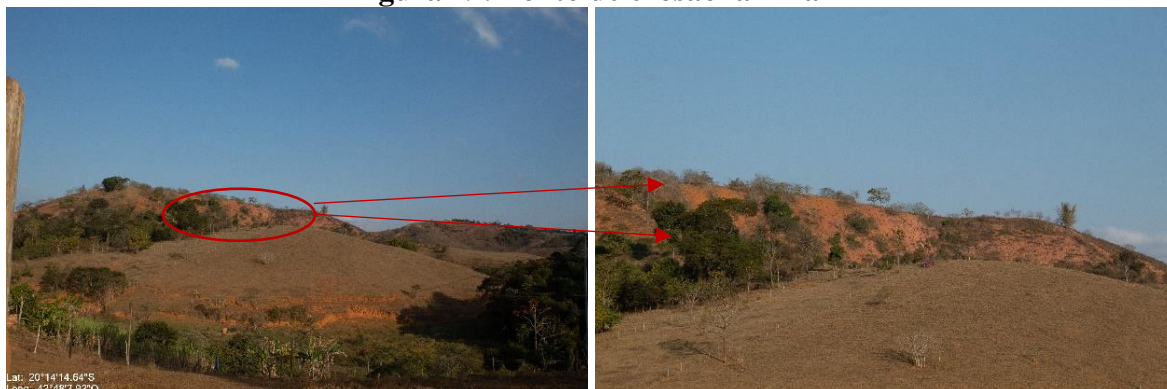
Figura 19: Ponto de erosão laminar
