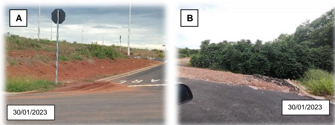
Figura 62 – Depósitos de materiais mistos no loteamento Júlio Alves
