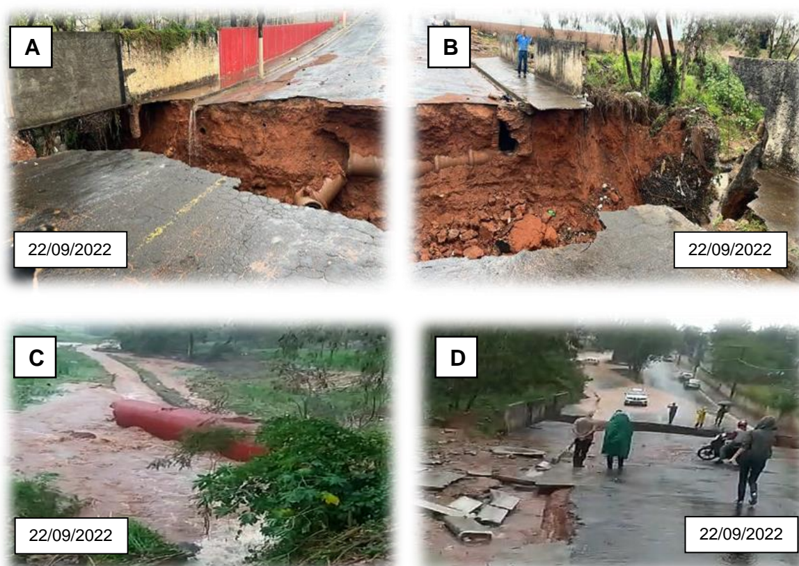
Figura 53 – Rompimento de sistema de drenagem no bairro Vila Betânia
