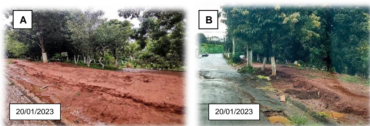
Figura 49 – Sulcos registrados em área de APP no bairro Residencial Oliveira
