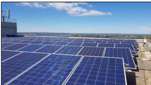
Usina Fotovoltaica TCU - Painéis Solares
