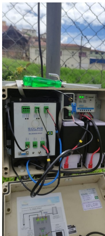
Fotografia 3 - Central de coleta, armazenamento e envio de dados da estação.
